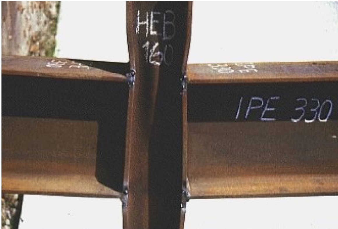
Abolladura del alma de la columna por aplastamiento entre las vigas
