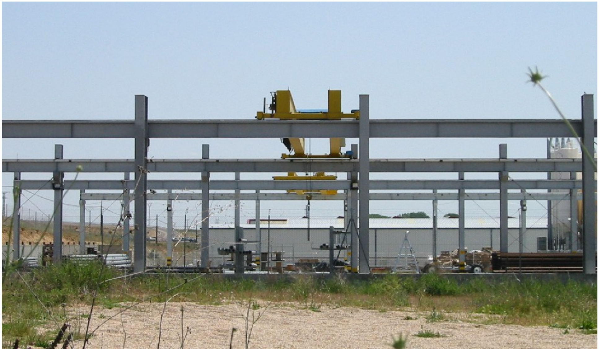
Nave con dos puentes grúa, cada uno de ellos de viga doble.
